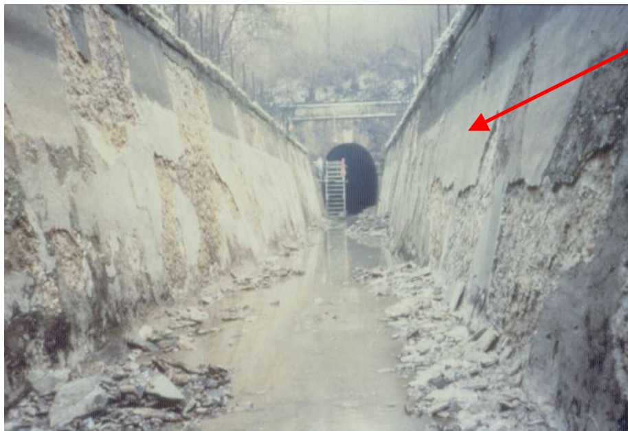
Dilavamento delle pareti di un canale in montagna
