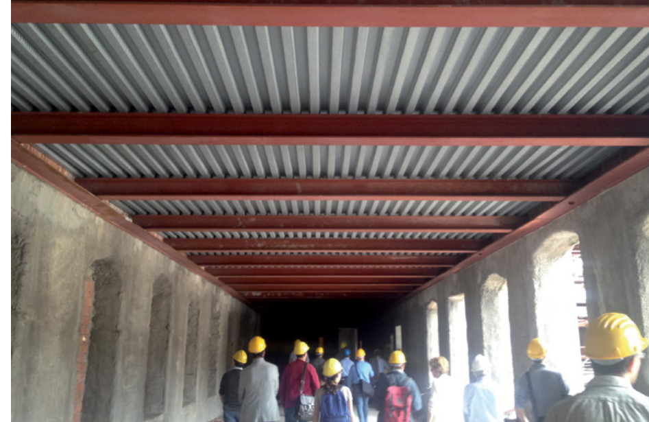
Momento di una visita guidata ai cantieri del complesso di Sant'Orsola, Firenze.
